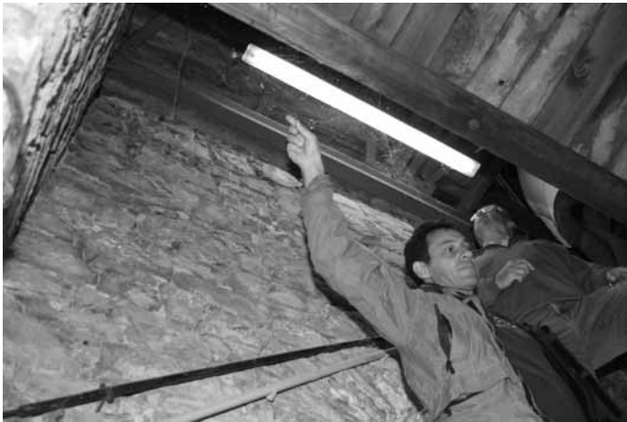
Dipl. Ing. G. Marsala erläutert die Schäden am Glockenstuhl der Erlöserkirche Foto: H. Bertermann
